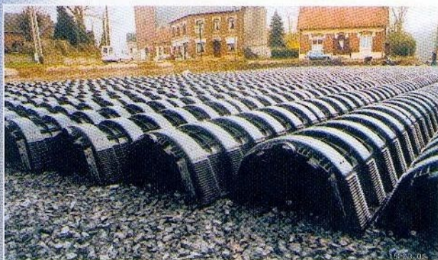
Bassin à Villers au flos
